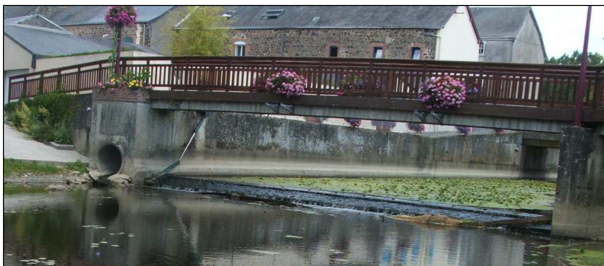
Figure 23 : Photographie du clapet des petites poulies
