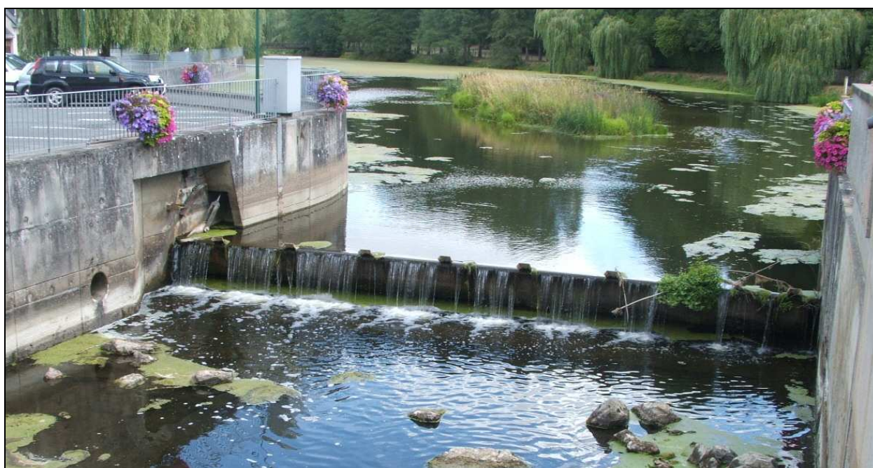
Figure 22 : Photographie du clapet du plan d'eau de Montsûrs
